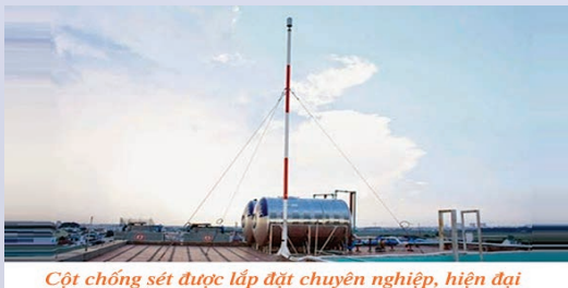
Cột chống sét được lắp đặt chuyên nghiệp, hiện đại
